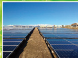
エータイム神戸第一発電所[神戸市西区]
